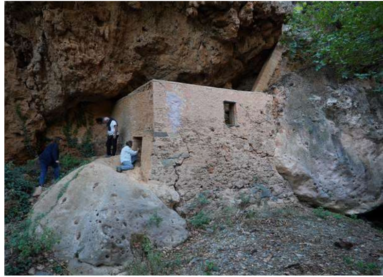
Εικ. 18 Ο νερόμυλος στα Λιρά χτισμένος κάτω και ανάμεσα σε τεράστια βράχια. Διακρίνονται οι έντονες ρηγματώσεις στην τοιχοποιία.
