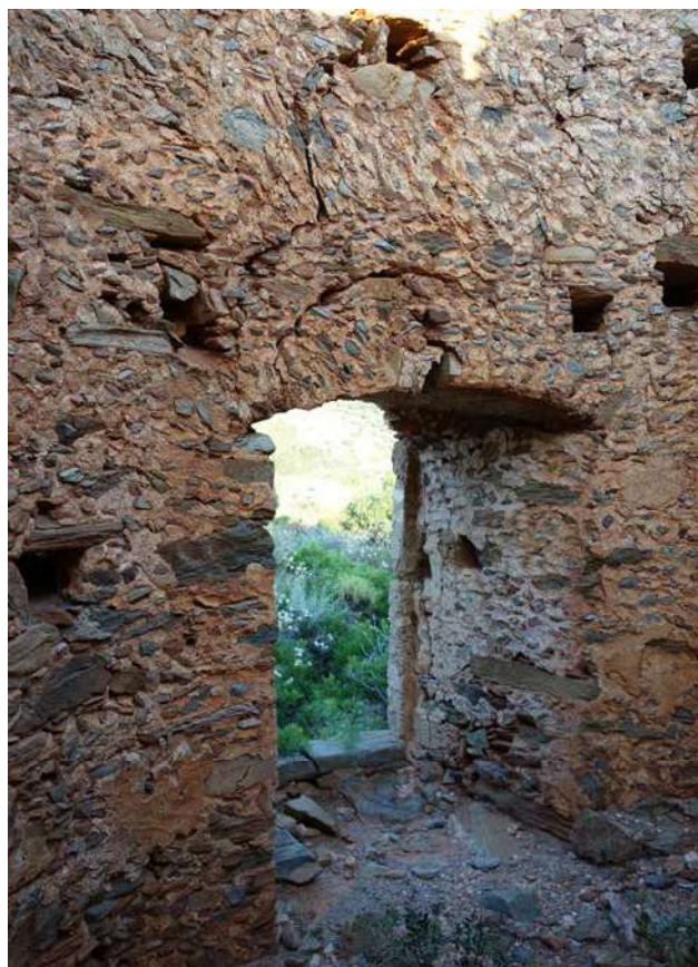
Εικ. 11 Ρωγμές στην τοιχοποιία του κάτω μύλου.
